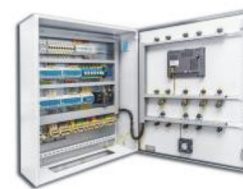
Автоматика теплового пункта
